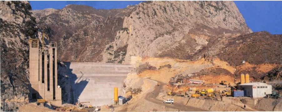
Figure 1-3. View of the working process of the hydrotechnical area. / Pamje e zonës hidroteknike gjatë fazës së punimeve (Anonymous, 1996).
